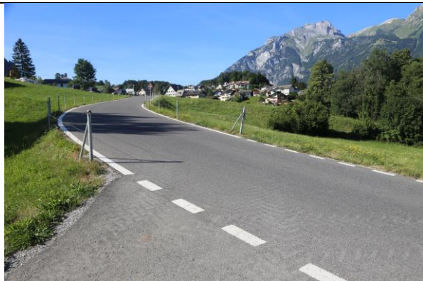
Blick bergwärts, die Güterstrasse mündet wenig unterhalb der Brücke über die Guppenrunse in die Kantonsstrasse
