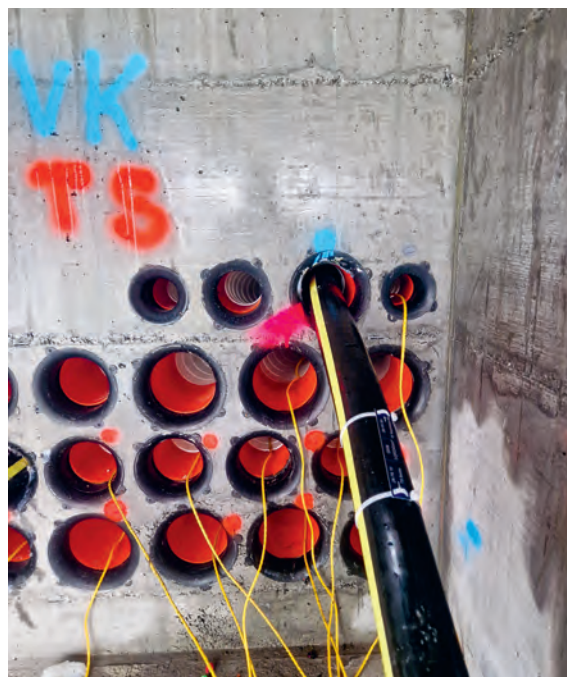
Das Innenleben eines Kabelschachtes.
