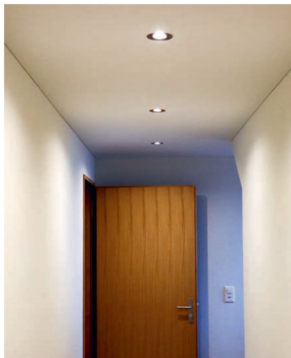
Elektroinstallationen im Flur.
