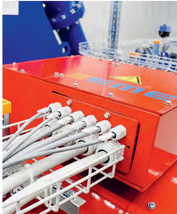
Anschlüsse des Generators.
