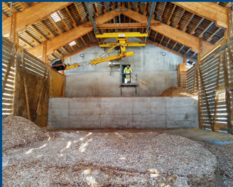
Den Füllstand des Schnitzelsilos im Blick – auch das gehört zum Kontrollgang in Linthal.
