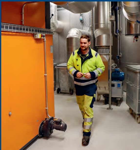
Rundgang in der Zentrale des Wärmeverbundes.
