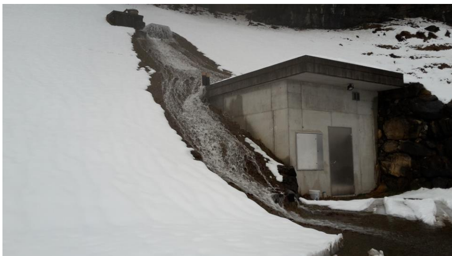
Abb.10 Wasseraustritt/Abfluss auf die Klausenpassstrasse
