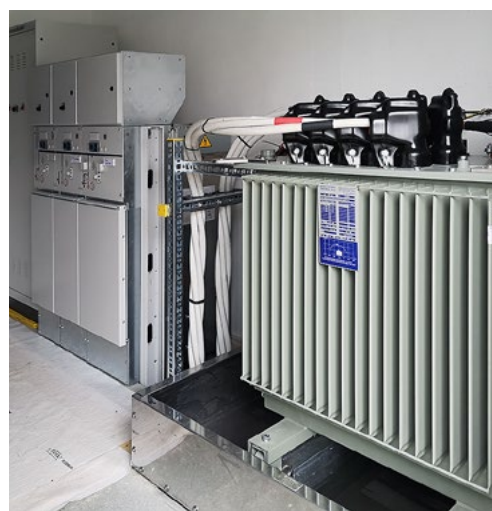
Berührungssichere Anlagen nach dem Umbau.
